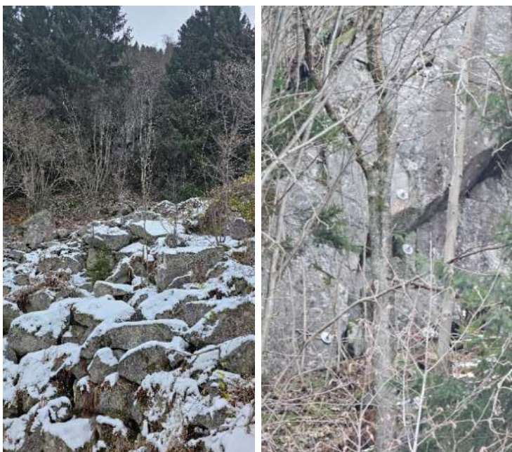
Figur 5-66: Rasur nedenfor infopunkt 9, og observert bergsikring som ble utført høsten 2019.
