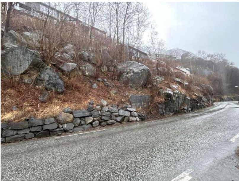
Figur 5-9: Urmassene nedenfor Skogen. Noen av blokkene står i fare for å remobiliseres ned på veg. Husene står på fjellterskel.
