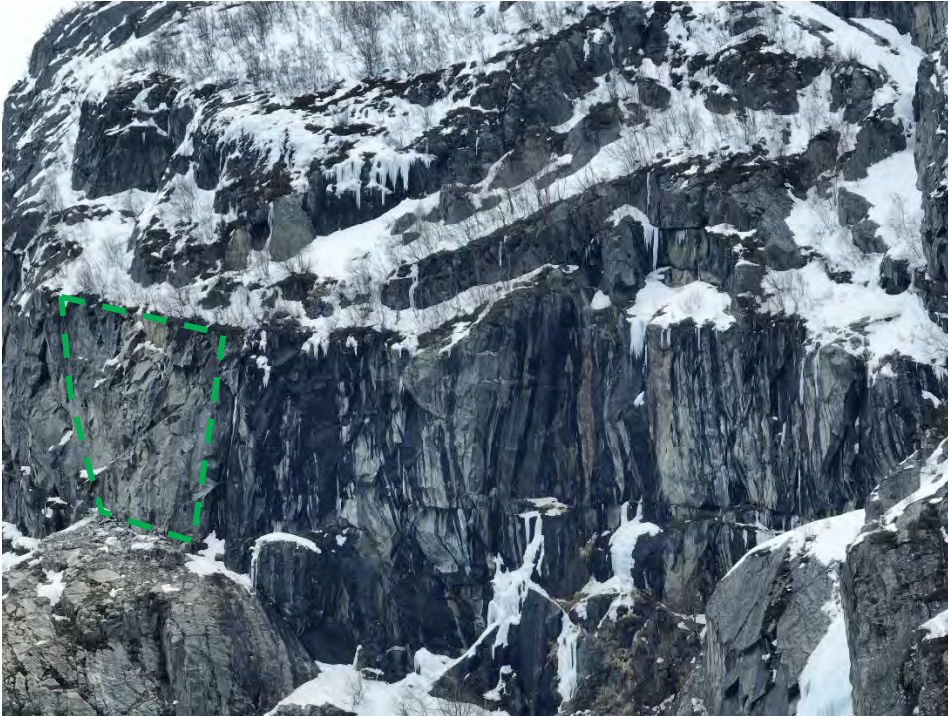
Figur 5-15: Nærbilde av deler av løsnedområdet for steinskred. Til venstre kan en se løsnedområdet til steinspranget i 2019 (omrisset med grønt).
