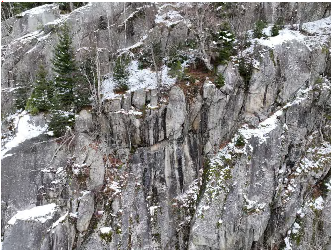
Figur 5-71: Nærbilde av et område med mye avløst berg og omfattende sikring.
