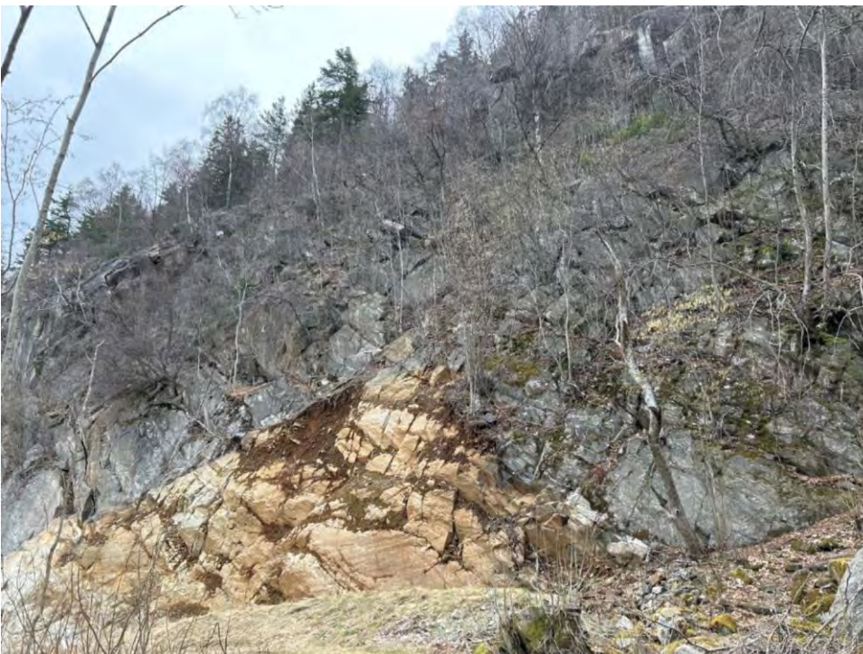
Figur 5-96: Bergskrenten ovenfor Lothepus camping ved infopunkt 127. Det er mye avløst berg i skrenten, og bergsikring ferdigstilles i løpet av våren 2024.
