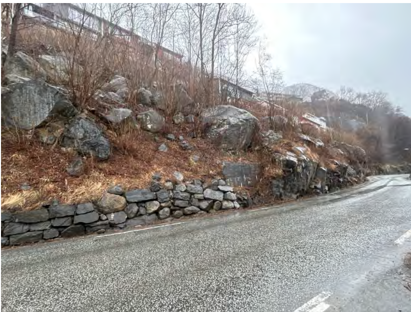
Figur 5-9: Urmassene nedenfor Skogen. Noen av blokkene står i fare for å remobiliseres ned på veg. Husene står på fjellterskel.
