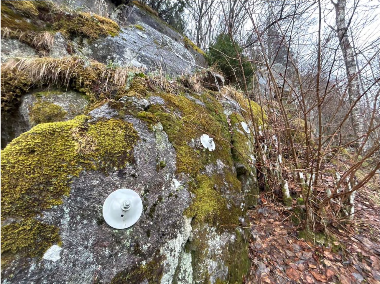
Figur 5-72: Boltetikret objekt ovenfor Ragdevegen 151 – 167.
