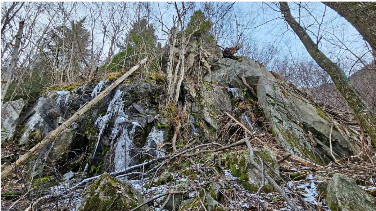
Figur 5-36: Skrenten nedenfor Byrkjehaug ved infopunkt 51. Bergmassen har varierende grad av oppsprekking. Det observeres vann tilstede i skrenten.
