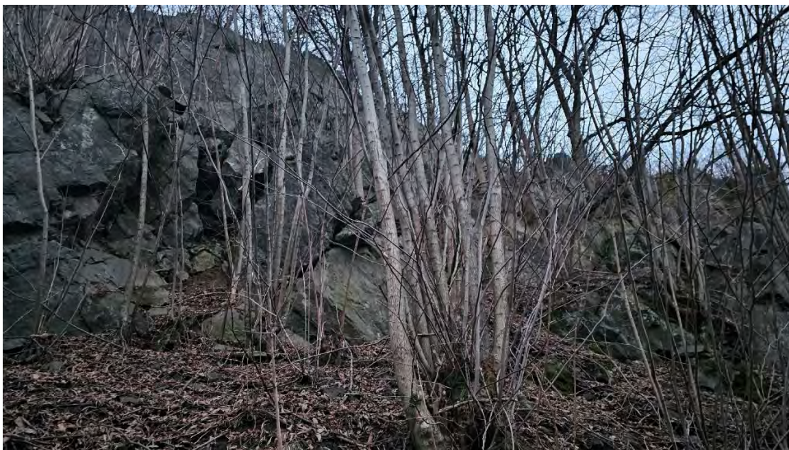
Figur 5-57: Oppsprukket og avløst berg i skrenten ovenfor Tyssedalsvegen.
