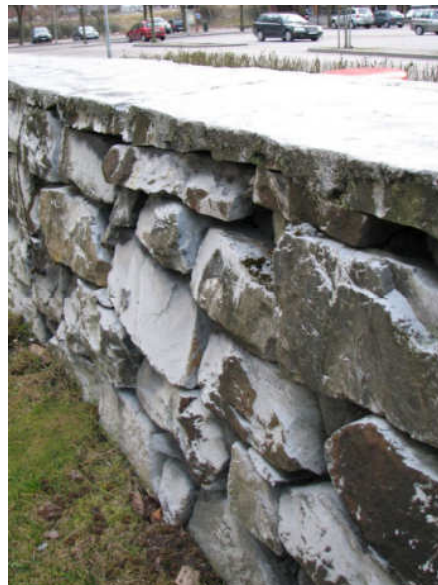
Belegg på vertikal mur. Kirkegårdsmuren.
