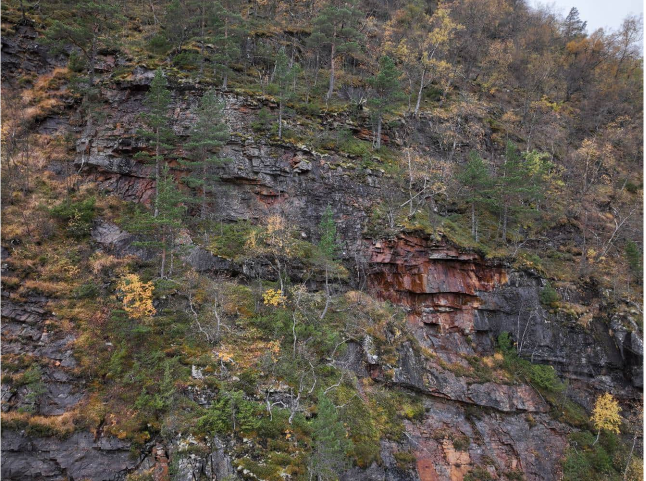
Figur 43 – Bilde fra påvirkningsområdet som viser subhorisontal oppsprekking. Bilde er fra største løsneområdet vist i Figur 44 med det største markerte området rødt stiplet omriss.
