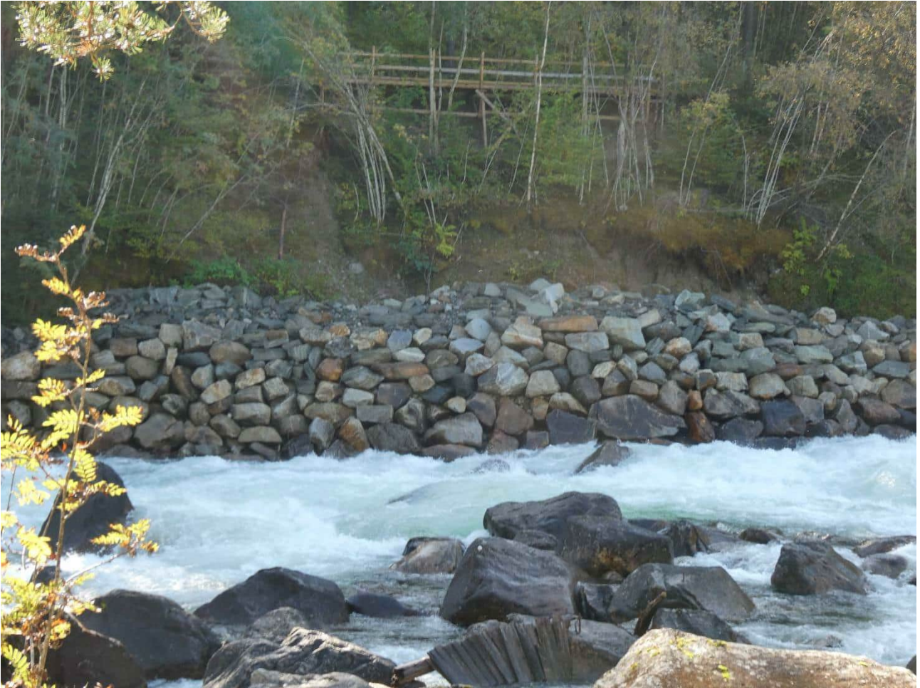
Figur 34 – Skråning langs elvebredden, synlig sig i bakkant av plastringen. Bilde tatt under befarung i 2023 [27]. Broen er oppsatt etter at gangstien gled ut i etterkant av storflom.
